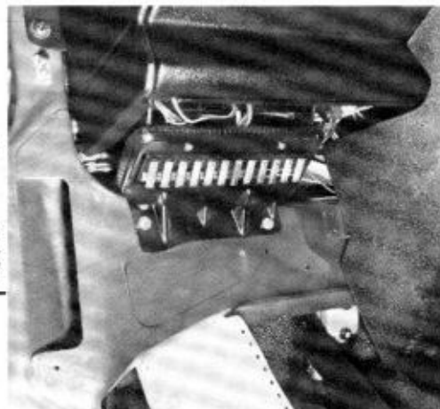
Emplacement des fusibles
